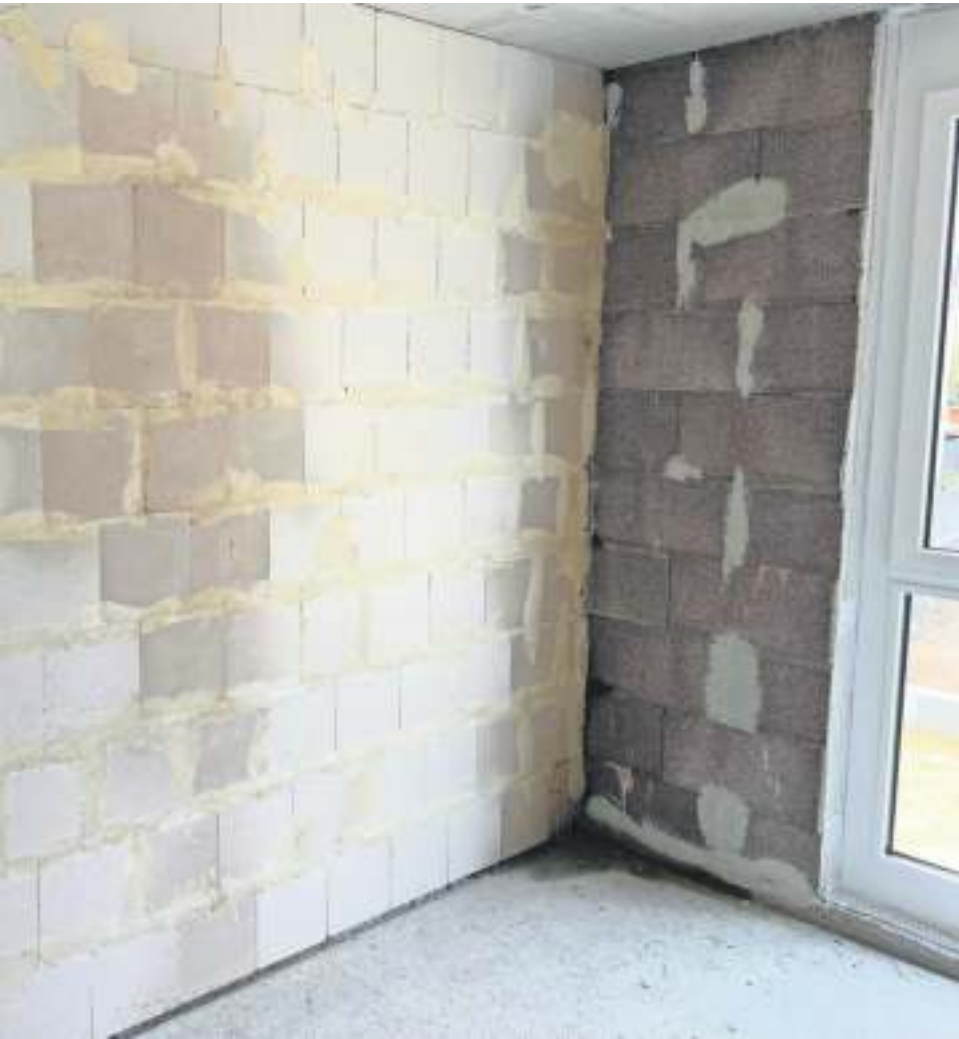
Wenn die Dämmung nicht stimmt, ist eine durchfeuchtete Wand keine Seltenheit.
