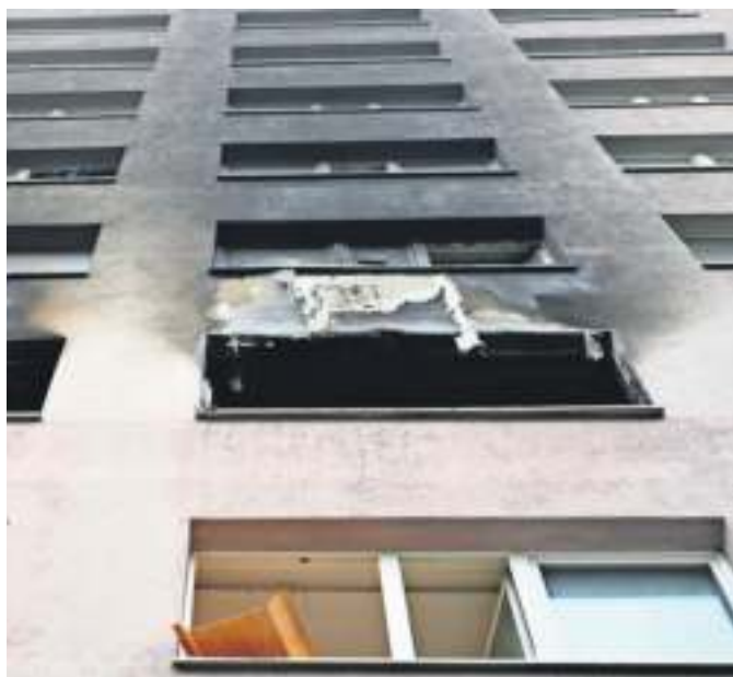
Spuren eines Brandes an einem Hochhaus in Berlin.
